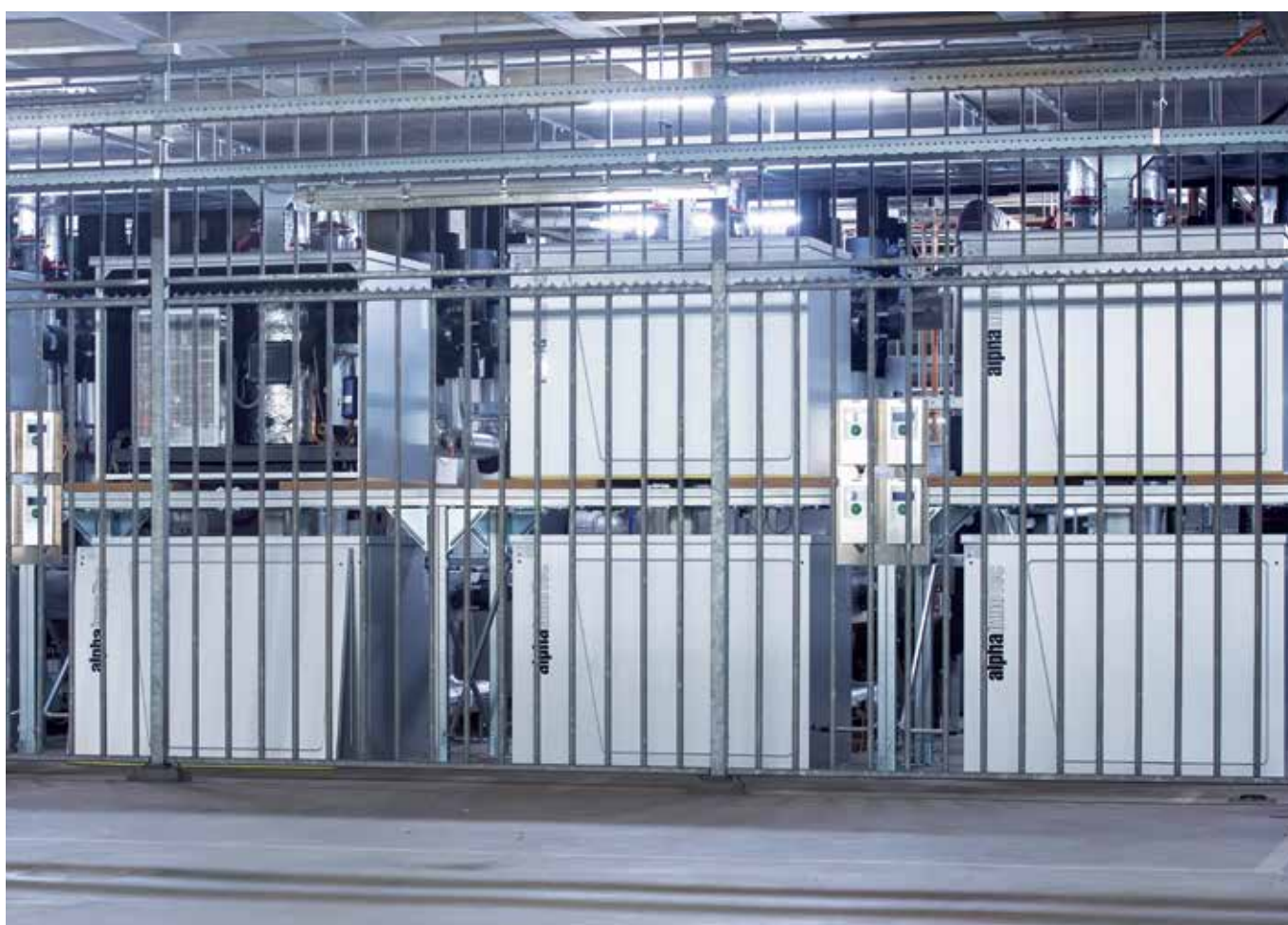
Kolverket Oranje Nassau III i Nederländerna, bildexempel med öppen värmepump (uppe till vänster)
